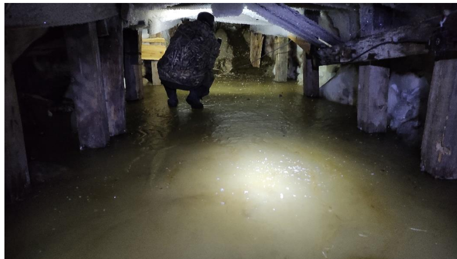
Затопление помещений (наледь)
