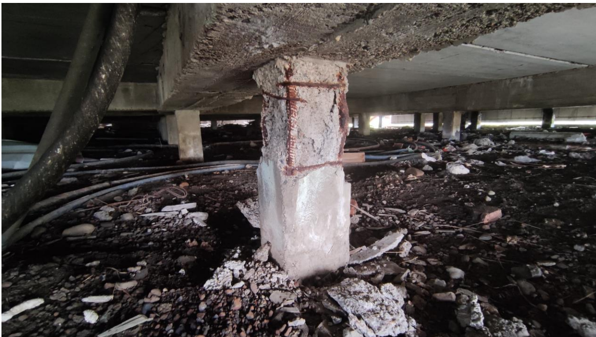
Раздавленная под нагрузкой свая здания детского сада, с. Лорино, Чукотский АО
