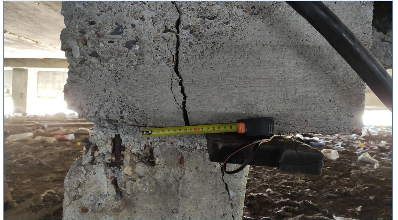
Трещина в балке ростверка под жилым 5-этажным домом №17 по ул. Сычёва, с. Лаврентия, Чукотский АО
