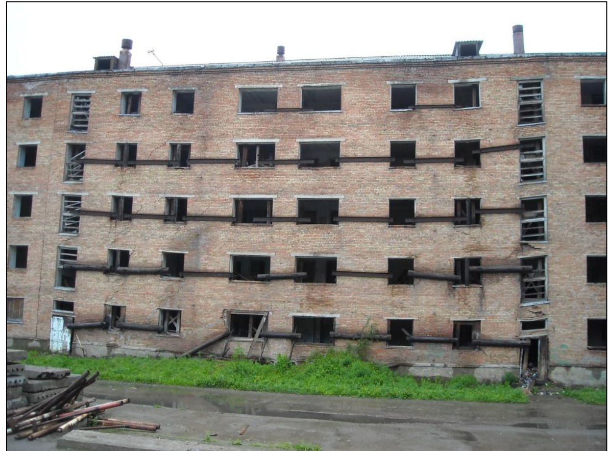
Деформированный дом после аварии трубопровода горячей воды
