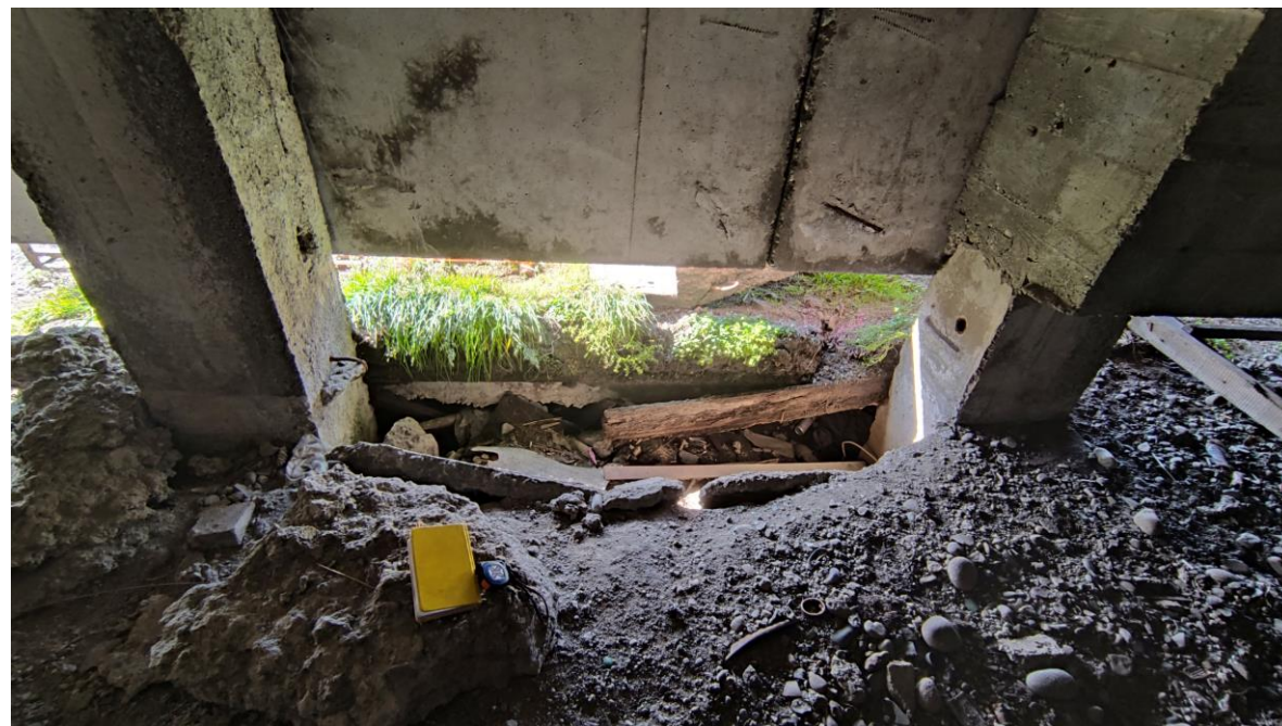
Термокарстовая каверна под домом №17 по ул. Сычёва, с. Лаврентия, Чукотский АО
