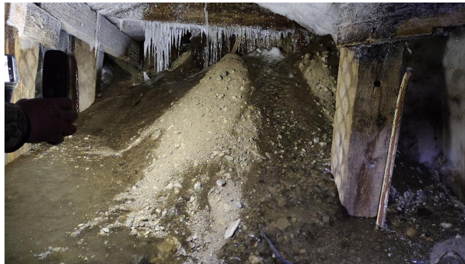
Обрушение основного входа
