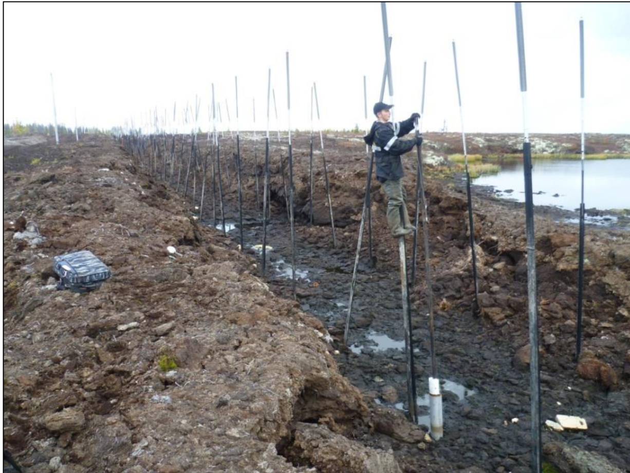
Термокарстовая канава над трубой нефтепровода, Западная Сибирь
